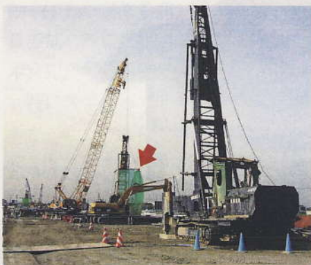
井池高架橋工事では、風が強く、周辺道路に場所打ち杭施工時の泥水が飛散する恐れがあった。そのため1mmメッシュの飛散防止ネット(赤い矢印の部分)を特注でつくった。作業員と考えた工夫の例
